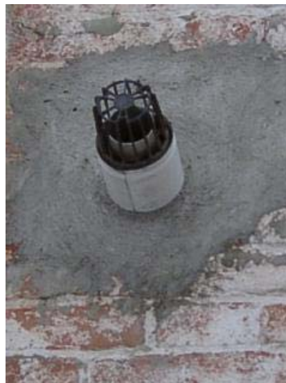
Рис. 8 Выброс дымовых газов через стену, без установки коллективного дымохода запрещен
